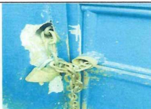
Foto 4: Vista de las chapas dañadas de las aulas del Centro Educativo
