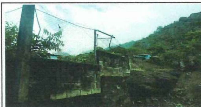
Foto 3: Vista de la malla dañada de la circulación
