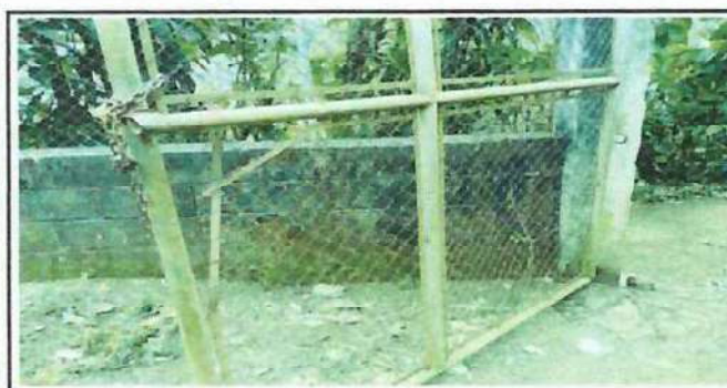
Foto 5: Vista del portón a sustituir
