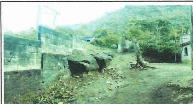
Foto 1: Vista del muro perimetral destruido
